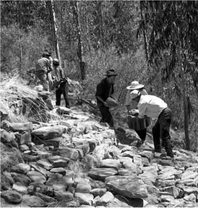
Consolidación en seco de una estructura en Molle Pujru. © María de los Ángeles Muñoz Collazos.
